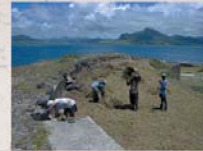
Cleaning the Upper Battery. Nettoyage de la Batterie Supérieure.
